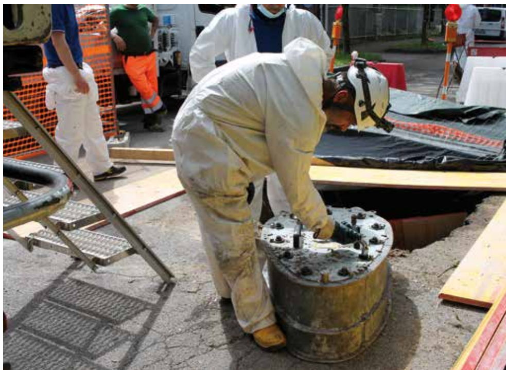
In alto, fase di inserimento liner. Sopra, fase di controllo dei packer metallici
