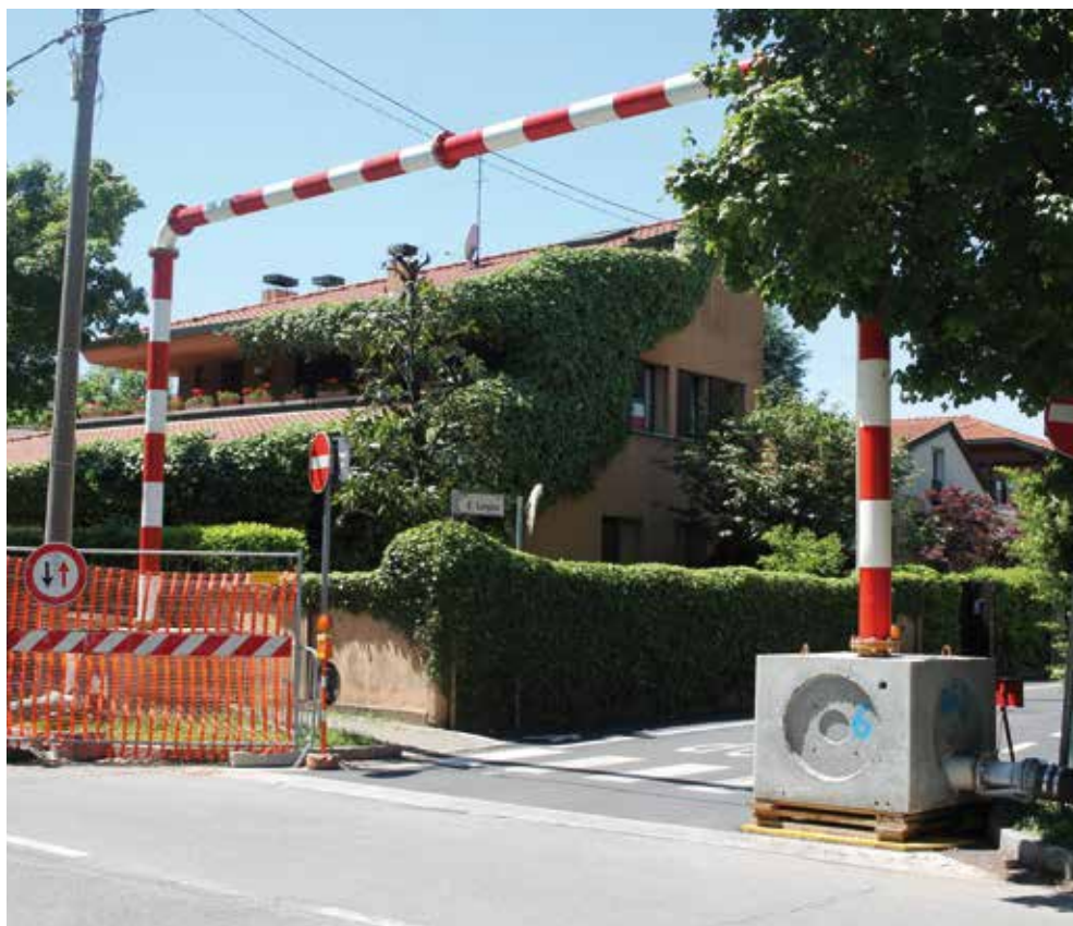
Bypass aereo di altezza 4,1m
