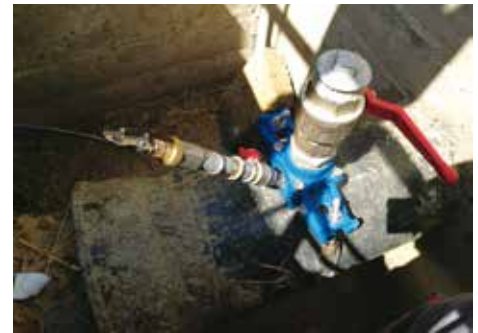
Dall'alto: collare con fibra installata in area test; presa in carico con fibra installata su condotta in servizio
